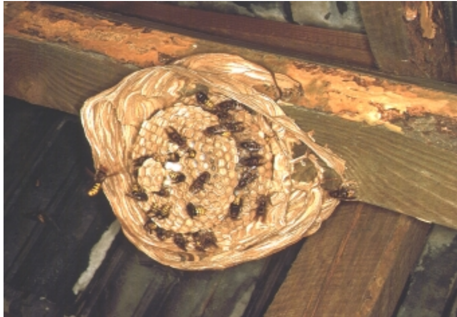
Hornissennest am Dachgiebel (Foto: H.R. Geiermann)
